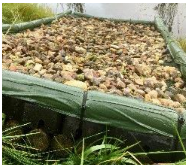
Orámování plovoucím lanem RepoFloat ST50, na ochranu překladiště šterku.
